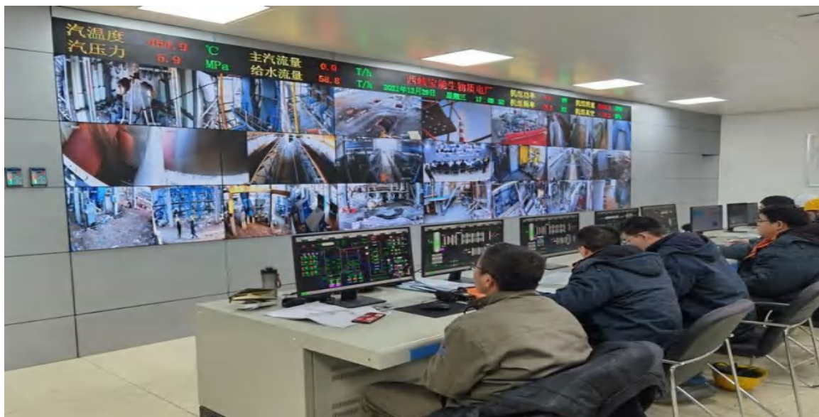
图 3-6 某火电机组集控运行监盘工作
