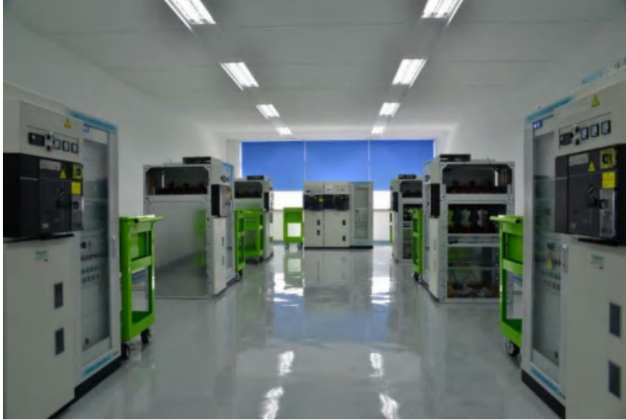
附图 1-7 宁波配网电力工控安全靶场实景图
