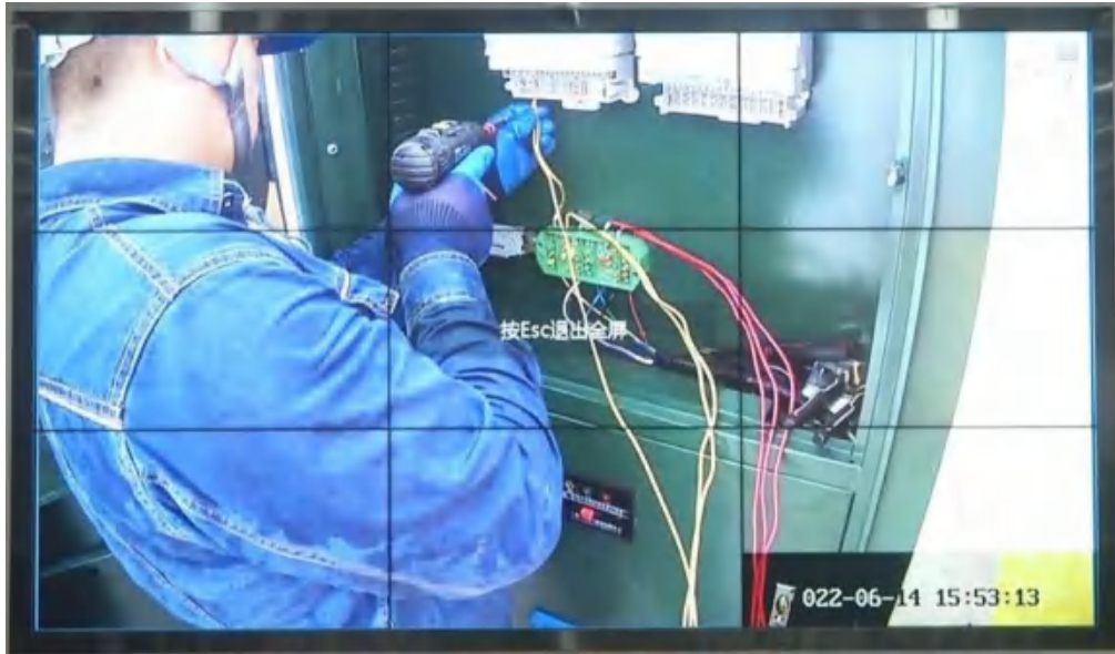
图 3-12 某营销作业现场移动安全视频终端监控
