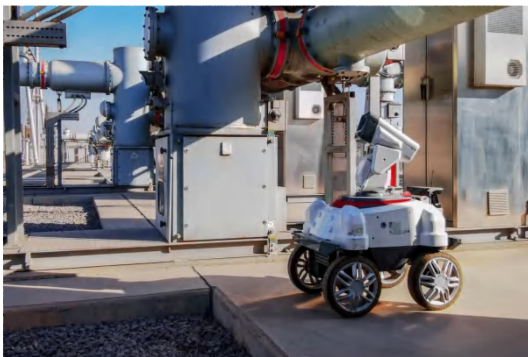
图 3-11 某变电站机器人巡检
